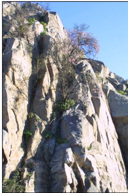
Figura 14. Vegetación entre las grietas
