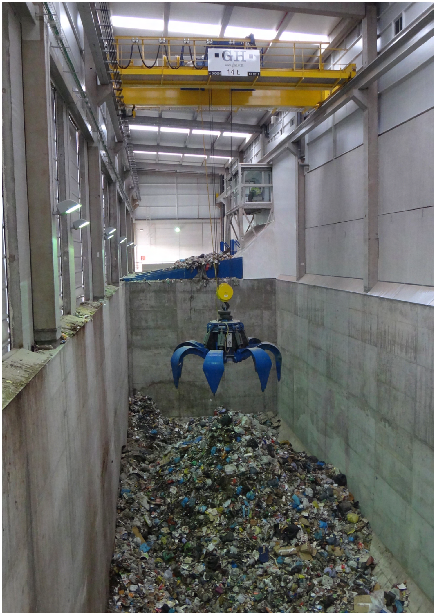
Foso de recepción del Ecoparque de Toledo. Fuente Infoenviro
